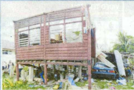
KEADAAN sebuah rumah di Kampung Sungai Baru, Jalan Kuala Sungai, yang rosak dibadai ribut.
